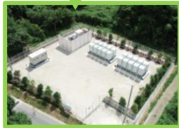
系統用蓄電所
