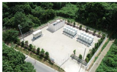
系統用蓄電所
