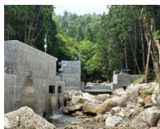
小水力発電 （滋賀県高島市・FIT）
